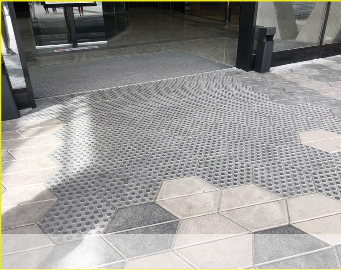
Marcaj tactil de avertizare, de exterior, Bilbao
